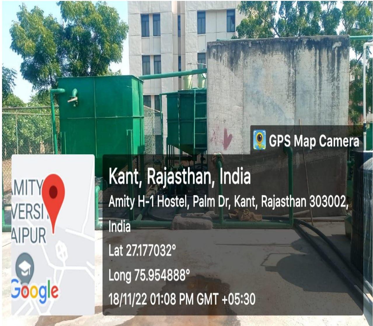
Effluent Treatment Plant (ETP)
