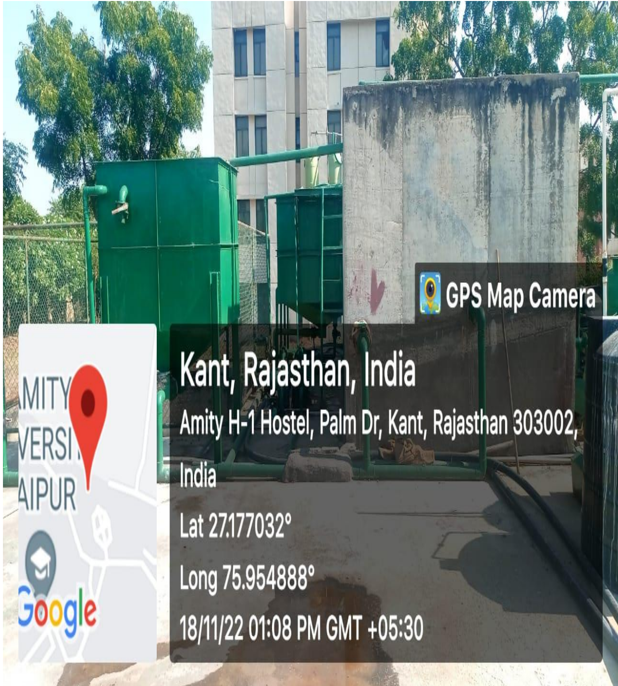
Effluent Treatment Plant (ETP)
